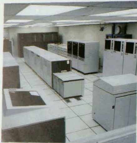
BANCO CENTRAL DE CHILE Oficina principal — Sala de computadores
